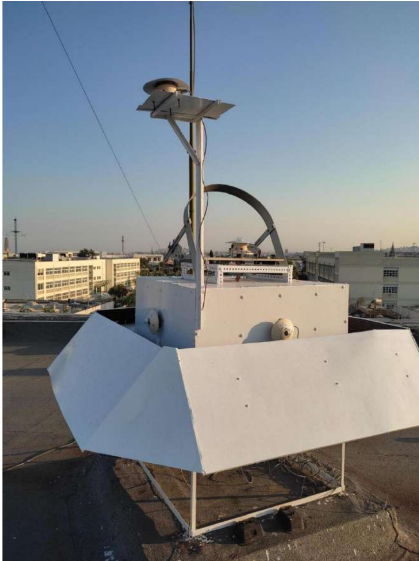
ΕΙΚΟΝΑ 8: ΤΕΛΙΚΗ ΕΙΚΟΝΑ ΤΗΣ ΕΓΚΑΤΑΣΤΑΣΗΣ ΜΕ ΤΟΠΟΘΕΤΗΜΕΝΑ ΠΥΡΑΝΟΜΕΤΡΑ
