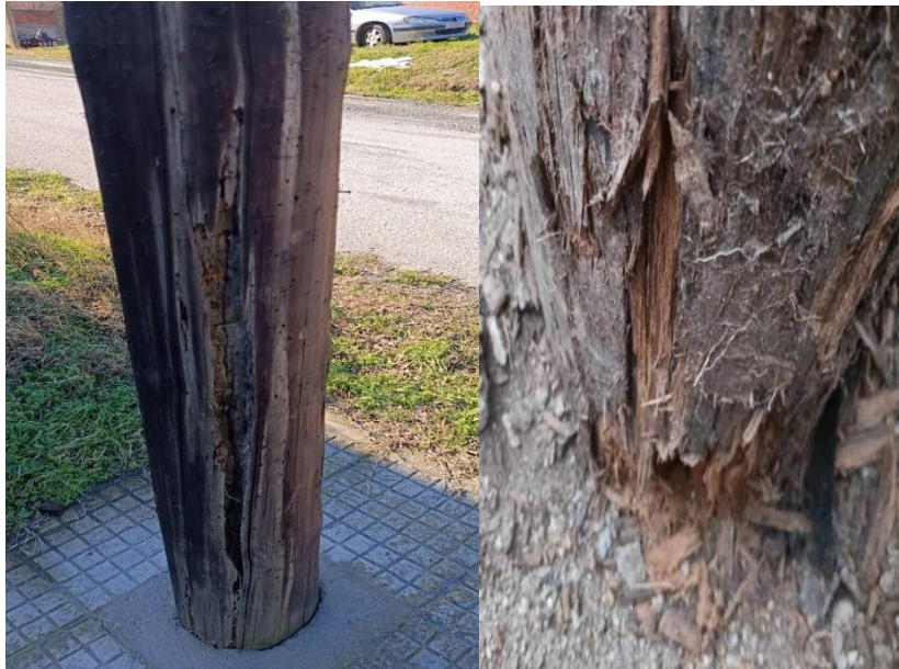
Εικόνα 15 Σήψη ξύλινου στύλου (αριστερά) & Σήψη στην επιφάνεια εδάφους (δεξιά)
