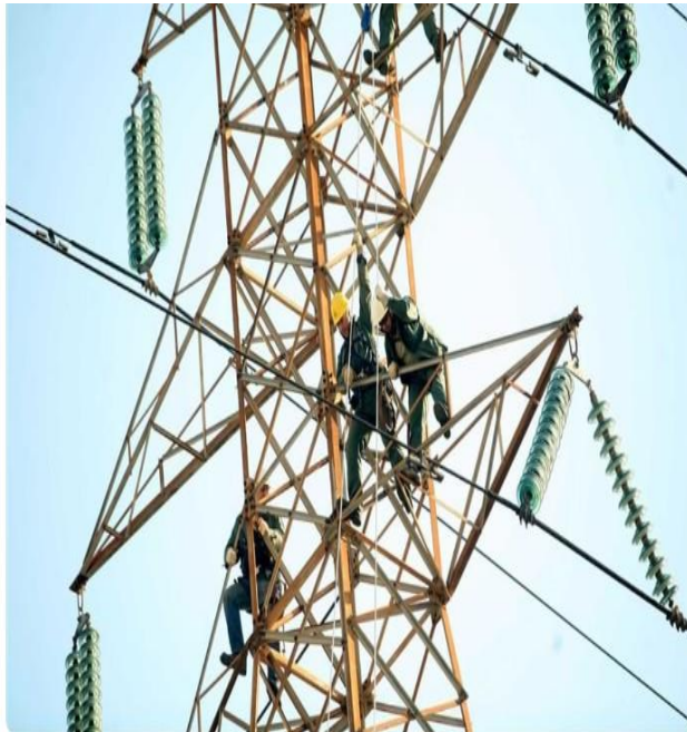
Εικόνα 38 Εναερίτες δικτύων μεταφοράς
