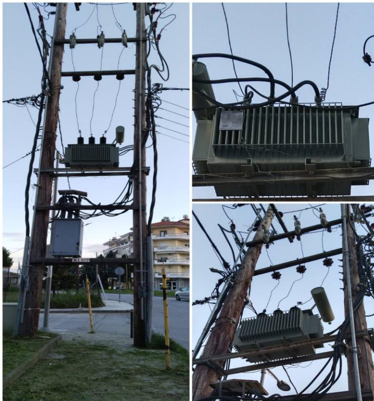
Εικόνα 34 Μετασχηματιστής Διανομής Τύπου Ελαίου σε εναέριο υποσταθμό
