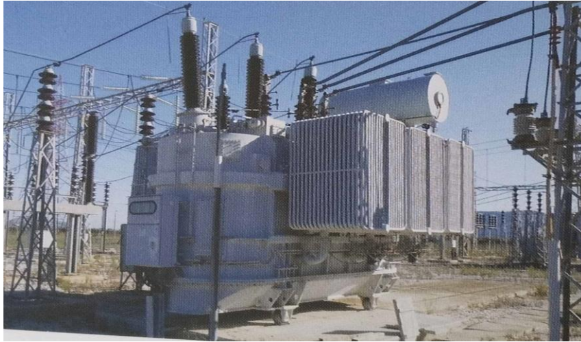
Εικόνα 33 Μετασχηματιστής Τύπου Ελαίου σε υπαίθριο υποσταθμό
