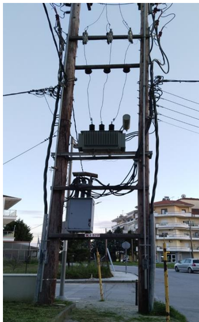
Εικόνα 4 Εναέριος υποσταθμός διανομής ηλεκτρικής ενέργειας
