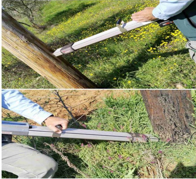
Εικόνα 19 Έλεγχος της κάτω επιφάνειας του εδάφους μέσω διάτρησης με χρήση Ρεζιστογράφου
