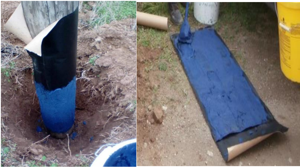
Εικόνα 24 Επάλειψη συντηρητικού απευθείας στον στύλο (αριστερά) & επάνω στο προς τοποθέτηση φύλλο κάλυψης του συντηρητικού (δεξιά)
