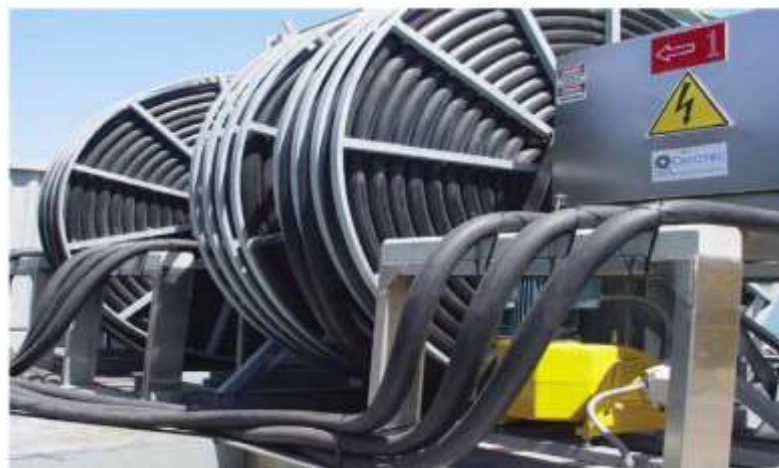
Εικόνα 1.25 : Καλώδια μέσης τάσης σε εγκατάσταση λιμανιού. [16]
