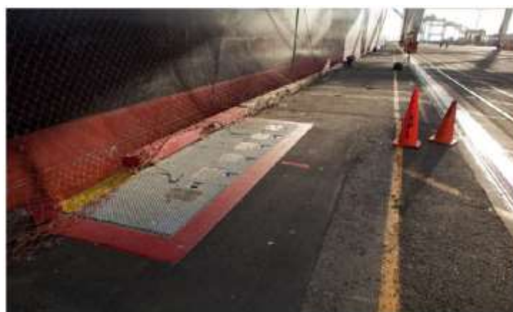
Εικόνα 1.27 : Εγκατάσταση υποδοχής καλωδίων τροφοδοσίας πλοίου. [16]
