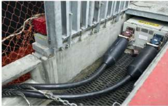
Εικόνα 1.28 : Υποδοχή καλωδίων τροφοδοσίας πλοίου. [16]
