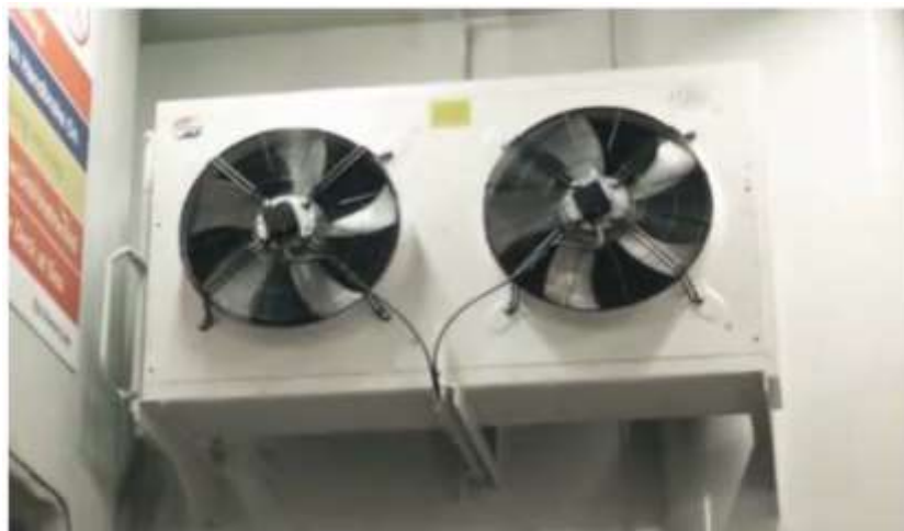
Εικόνα 1.37 : Σύστημα ψύξης ή αερισμού των ηλεκτροστασίων του πλοίου. [15]
