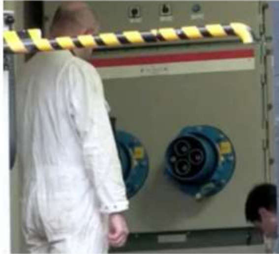
Εικόνα 1.38 : Θέσεις υποδοχής καλωδίων πάνω στο πλοίο. [15]
