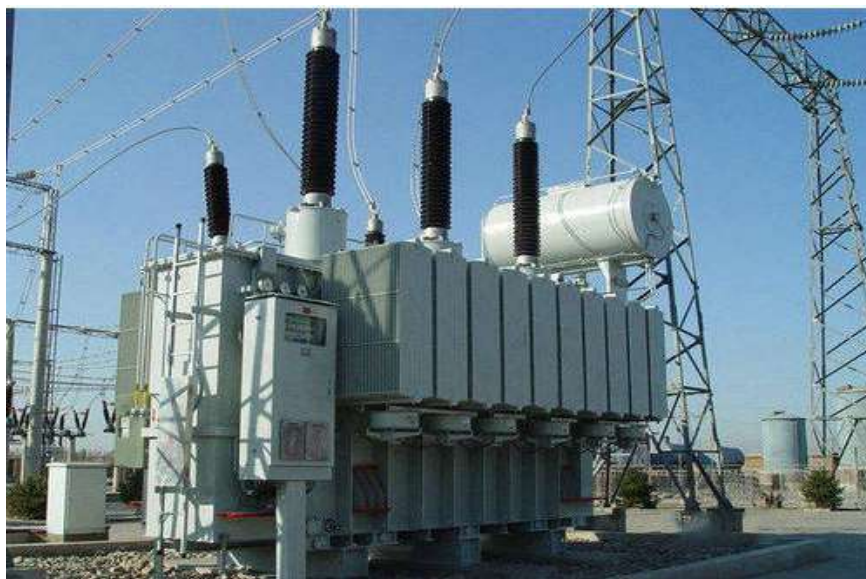
Εικόνα 1.20 : Παράδειγμα Μετασχηματιστή 230 kV – 156.000 kVA. [14]
