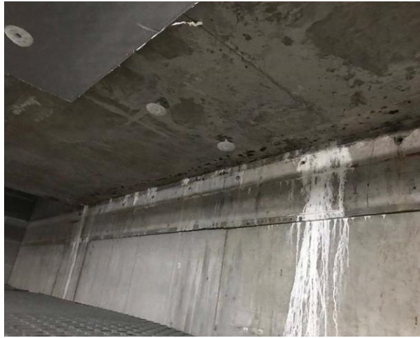
Εικόνα 2.4: Διαρροή υγρασίας σε σκυρόδεμα
