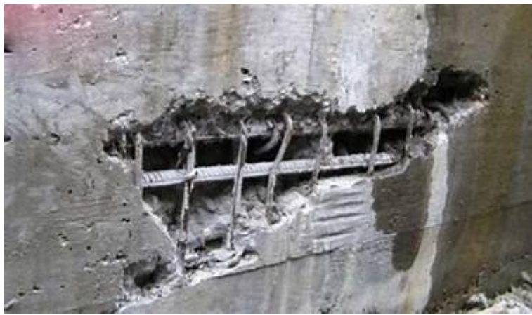
Εικόνα 2.5: Εκτεθειμένος οπλισμός σκυροδέματος
