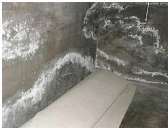
Εικόνα 2.3: Εξίδρωση σκυροδέματος Πηγή: www.buellinspections.com
