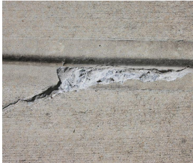
Εικόνα 2.2: Αποκόλληση σκυροδέματος Πηγή: Ολυμπία Οδός
