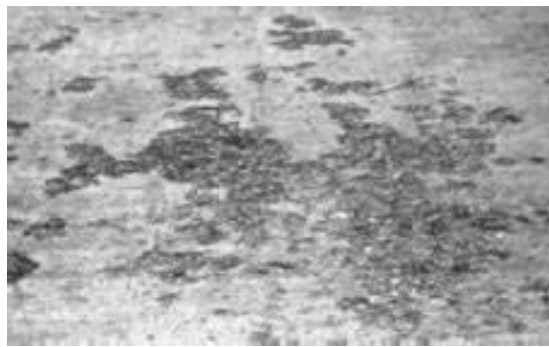
Εικόνα 2.1: Αποφλοιώση σκυροδέματος Πηγή: www.nevadareadymix.com
