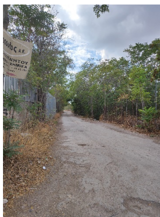
Εικόνα 19 : Κακή κατάσταση οδοστρώματος Πηγή : Ιδία λήψη
