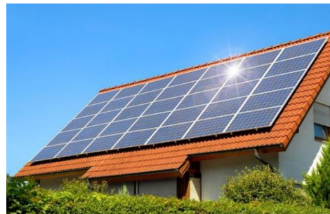
Εικόνα 6: Οικία με ηλιακό συλλέκτη στην οροφή
