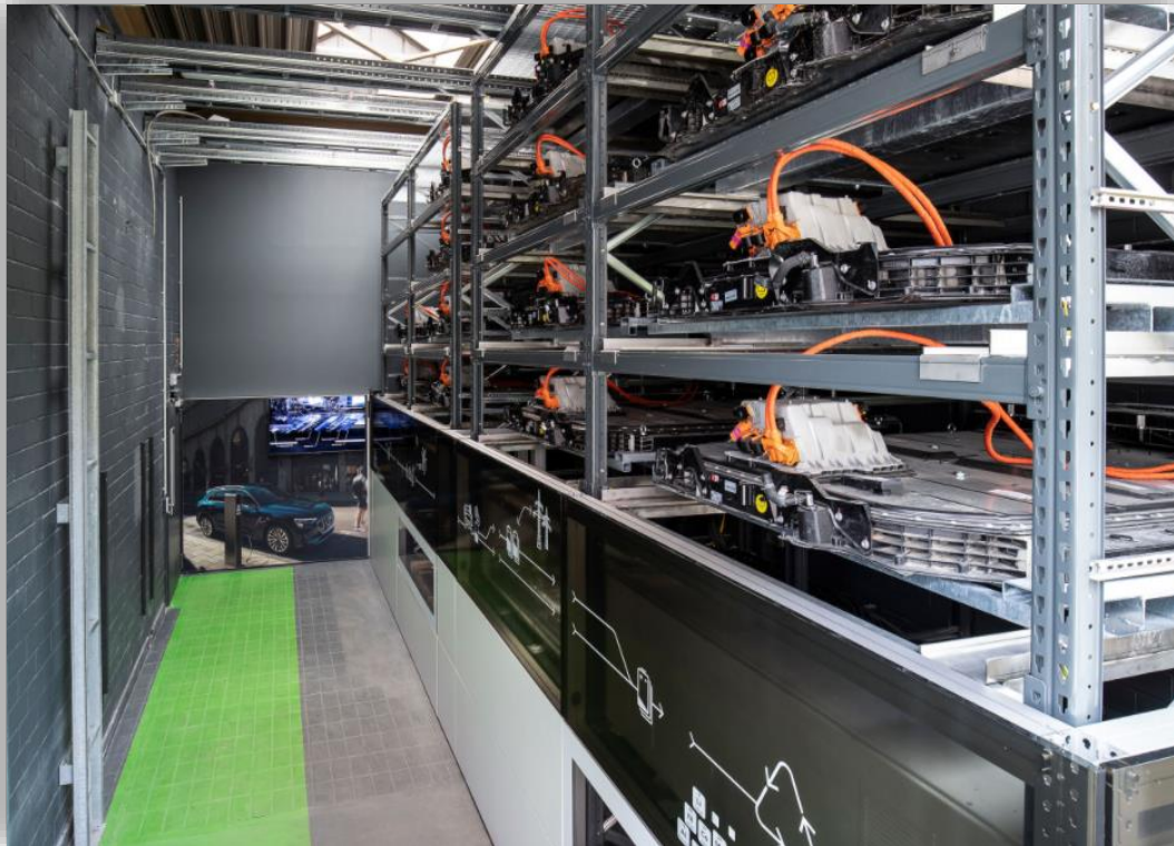
Εικόνα 2.2: Εγκατάσταση αποθήκευσης ενέργειας στο Βερολίνο από την Audi. (Τα πνευματικά δικαιώματα της εικόνας ανήκουν αποκλειστικά στην Audi). Πηγή: Audi [22]
