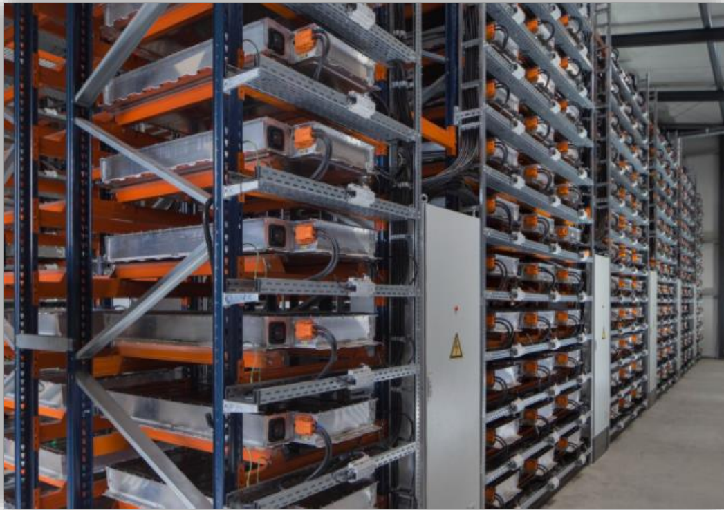
Εικόνα 2.1: Εγκατάσταση αποθήκευσης ενέργειας από την BMW στη Λειψία. Πηγή: Slashgear [21]
