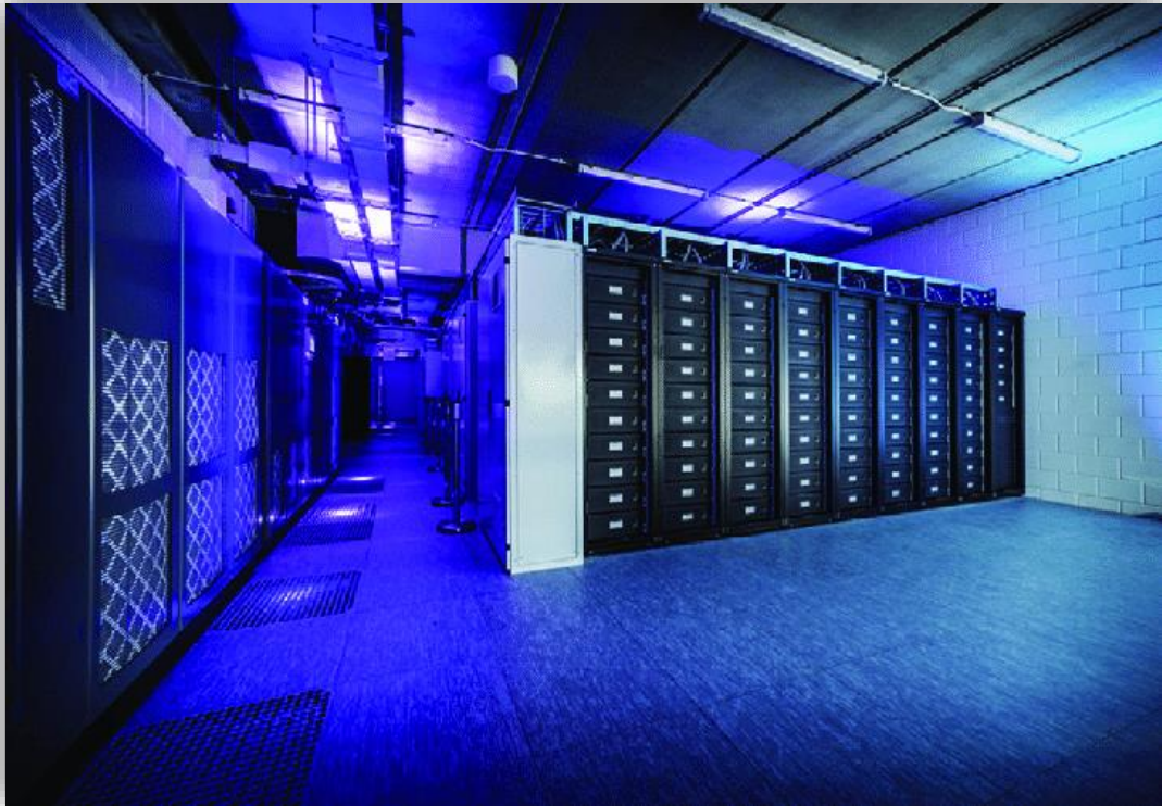
Εικόνα 2.4: Εγκατάσταση αποθήκευσης ενέργειας στο στάδιο Johan Cruyff Arena. Πηγή: Mario Pagliaro & Francesco Meneguzzo [25]
