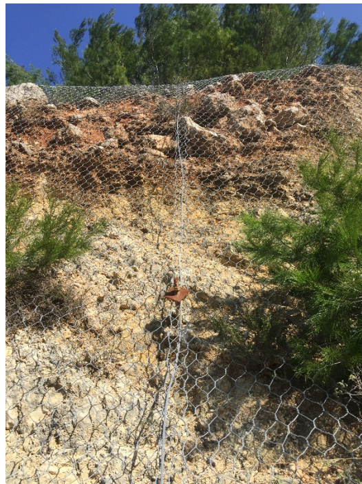
Εικόνα (7.4) Μεταλλικό πλέγμα και αγκύριο που αστόχησε (Μαλακάσα) (Προσωπικό αρχείο)
