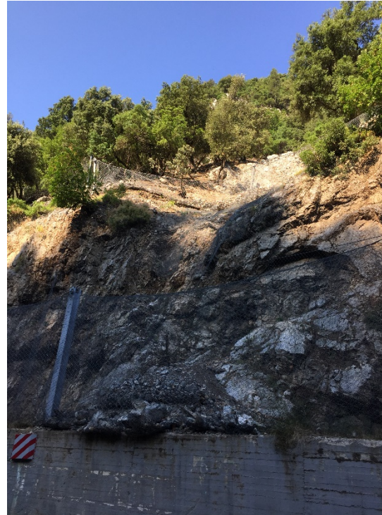
Εικόνα (7.6) Μεταλλικό Δίκτυ γεμάτο με προϊόντα καταπτώσεων (ΕΟ Χαλκίδας – Αιδηψού) (Προσωπικό αρχείο)
