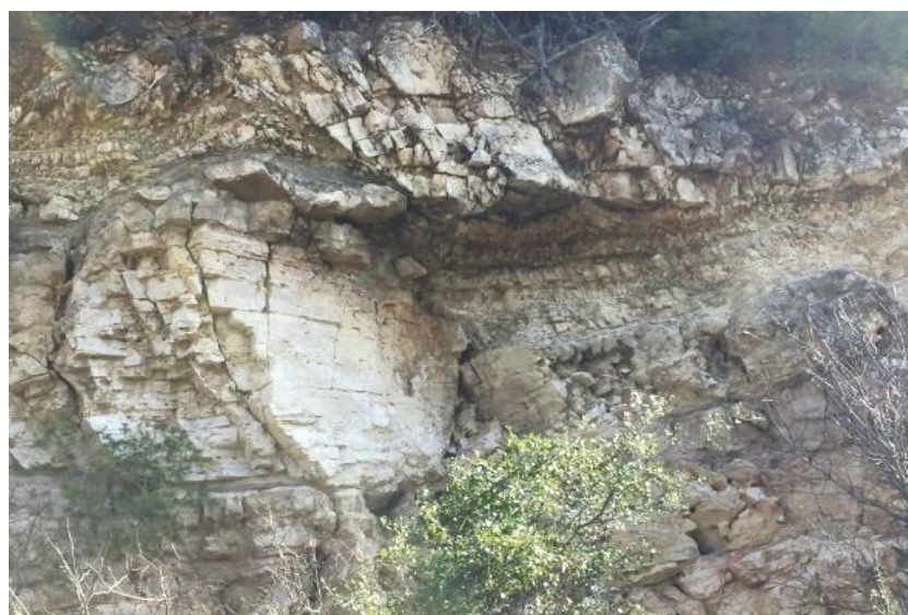
Εικόνα (2.15) Επιφάνεια που έχει αποκολληθεί βράχος, και έντονες ασυνέχειες (Μαλακάσα) (Προσωπικό αρχείο)
