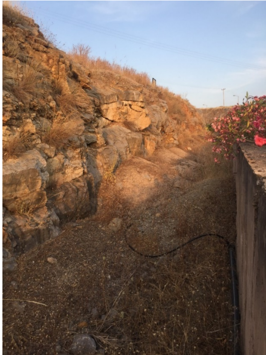
Εικόνα (7.5) Τάφρος ανάσχεσης καταπτώσεων με υποστήριξη από δύσκαμπτο φράχτη (Χαλκίδα) (Προσωπικό αρχείο)
