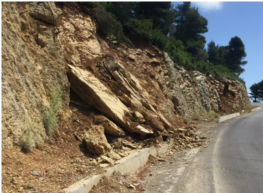
Εικόνα (7.2) Συνδυασμός κατάπτωσης με αστοχία βραχώμαζας. Μη επαρκής τοίχος (ΕΟ Χαλκίδας – Αιδηψού) (Προσωπικό αρχείο)
