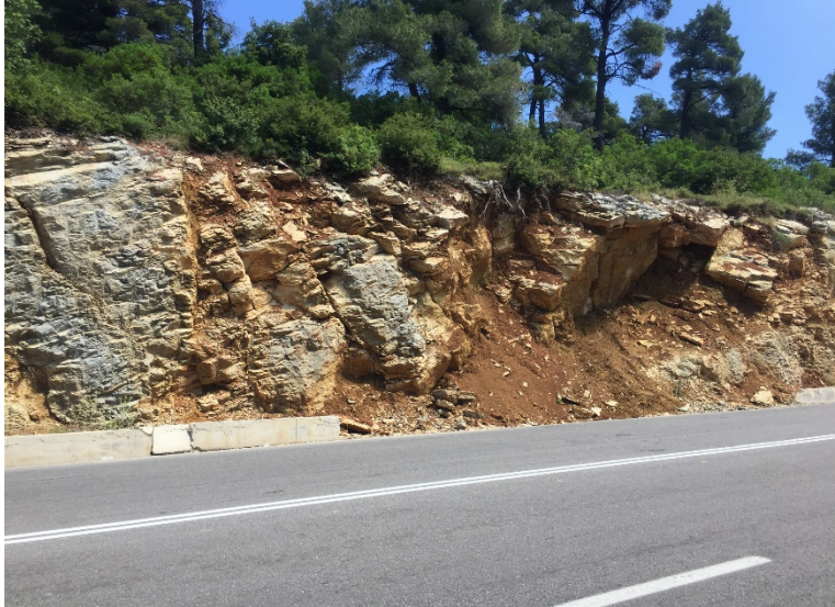
Εικόνα (7.1) Αστοχία μικρού τοίχου από κατάπτωση (ΕΟ Χαλκίδας – Αιδηψού) (Προσωπικό αρχείο)
