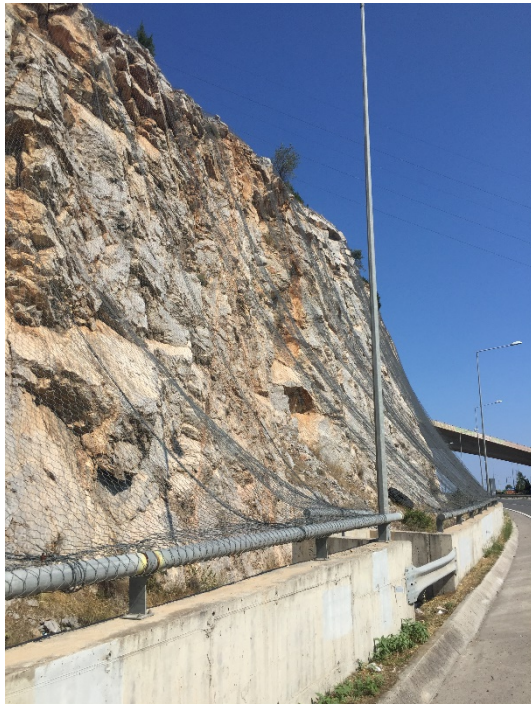
Εικόνα (7.9) Μεταλλικό δίκτυο αγκυρωμένο σε φράχτη σκυροδέματος (Αυτοκινητόδρομος Α11 Σχηματαρίου – Χαλκίδας) (Προσωπικό αρχείο)
