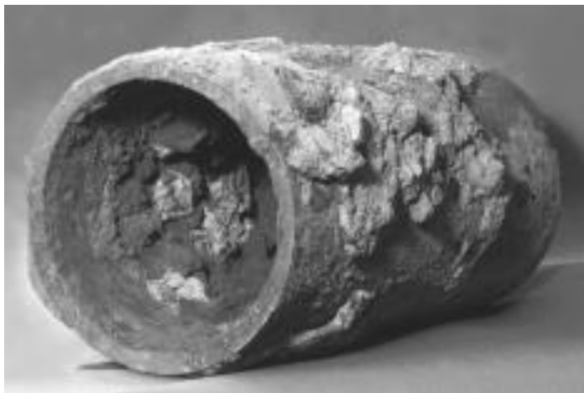
Εικόνα 4.1 Διαβρωμένος σωλήνας δικτύου διανομής νερού από βιοφίλμ (Πηγή: MSU Center for Biofilm Engineering)
