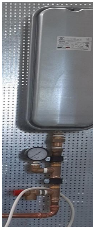
Εικόνα 7.3 Δοχείο διαστολής και Μανόμετρο (πίεση νερού 1bar)
