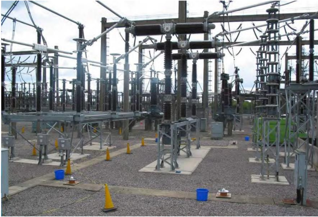
Εικόνα 1.6: Υποσταθμός υψηλής/υπερυψηλής τάσης
