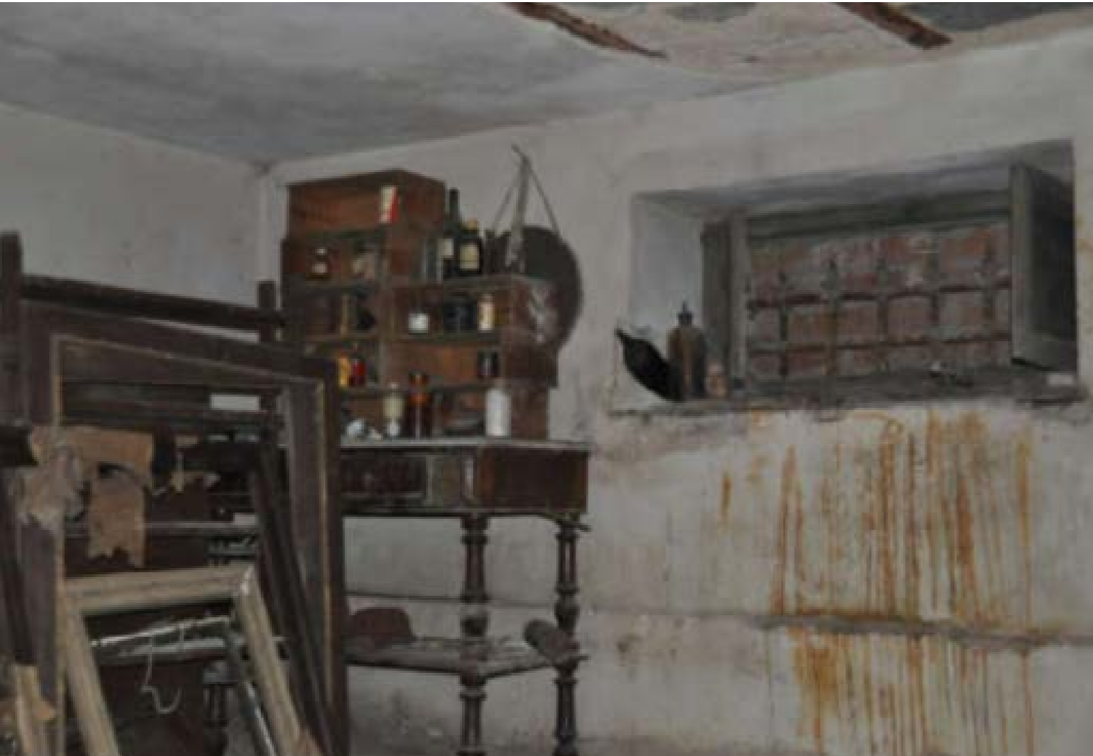
Εικ.16. Καλπογιάννη, Μ., Τζουβελέκη, Β., Φιαμέγκου, Θ. "Υπάρχουσα κατάσταση χώρου X1" (2016),
