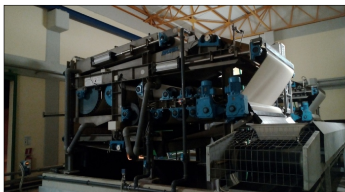
Εικόνα 4.28 Μονάδα Αφυδάτωσης (εικόνα ΚΕΛΘ)
