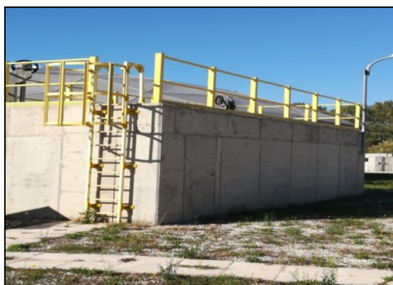
Εικόνα 4.12 Φρεάτιο μερισμού (εικόνα ΚΕΛΘ)
