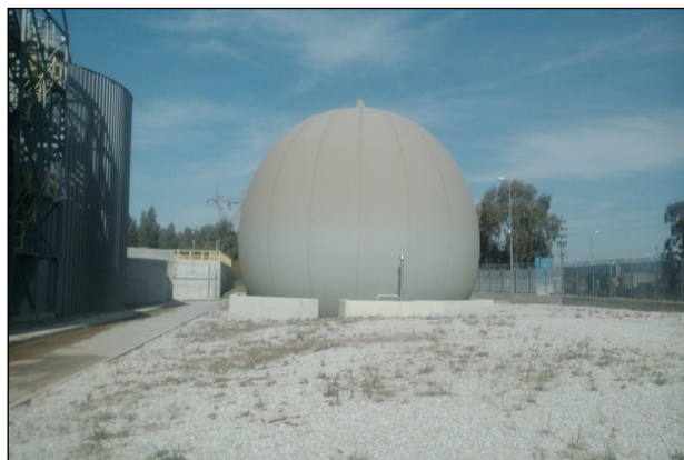
Εικόνα 4.25 Αεριοφυλάκιο (εικόνα ΚΕΛΘ)
