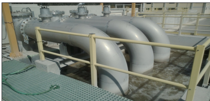
Εικόνα 4.14 Φρεάτιο μερισμού (εικόνα ΚΕΛΘ)
