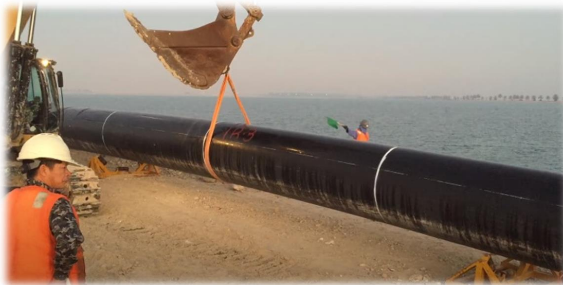
Σχήμα 4.1: Ρυμούλκηση αγωγού HDPE από εκσκαφέα με ερπύστριες προς τη θάλασσα στο Qatar (πηγή https://www.youtube.com/watch?v=M_EjmG7K4aU )
