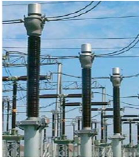
Σχήμα 4.11: Μετασχηματιστής ρεύματος Alstom OSKF 765 [5]
