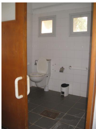
Εικόνα 107 Υπάρχουσα κατάσταση wc θαλάμου αναπήρων (2019) Πηγή : Προσωπικό αρχείο
