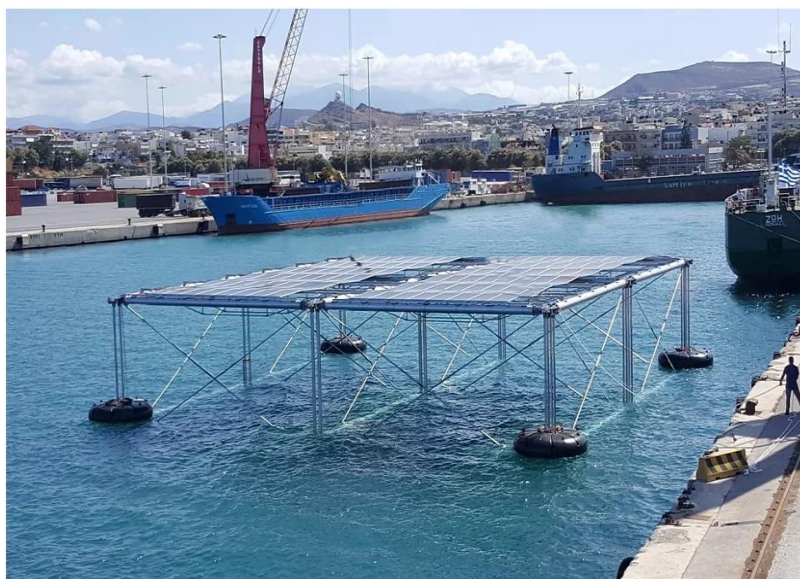
Εικόνα 33. Πιλοτικό έργο υβριδικής πλατφόρμας με ΦΒ στο λιμάνι του Ηρακλείου. [124]
