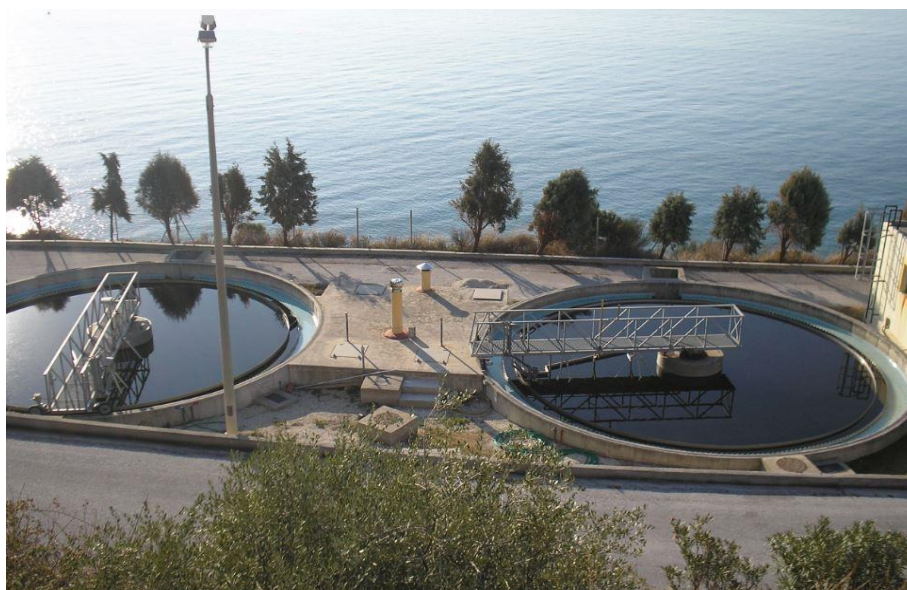
Εικόνα 4. Μονάδα επεξεργασίας αποβλήτων, δεξαμενές καθίζησης. [28]
