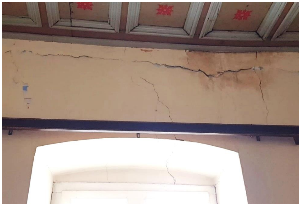
Εικόνες 3.2 – Ρηγματώσεις και καθαιρέσεις επιχρίσματος στις γωνίες και στην συναρμογή της οροφής με τις τοιχοποιίες
