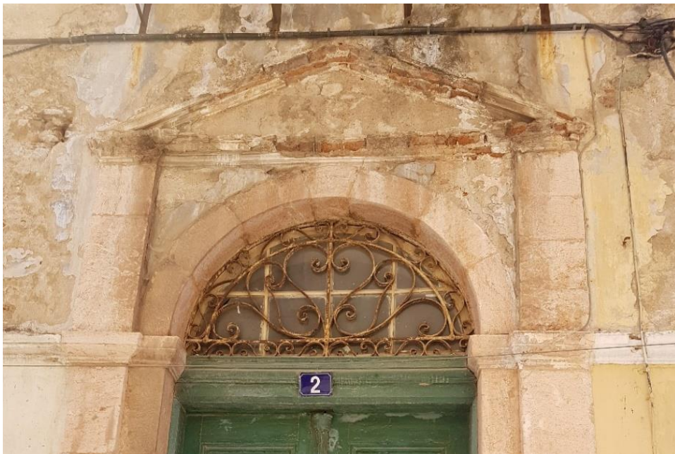
Εικόνα 3.4 – Φθορές στο εξωτερικό επίχρισμα και στο αέτωμα της πλαισίωσης του ανοίγματος
