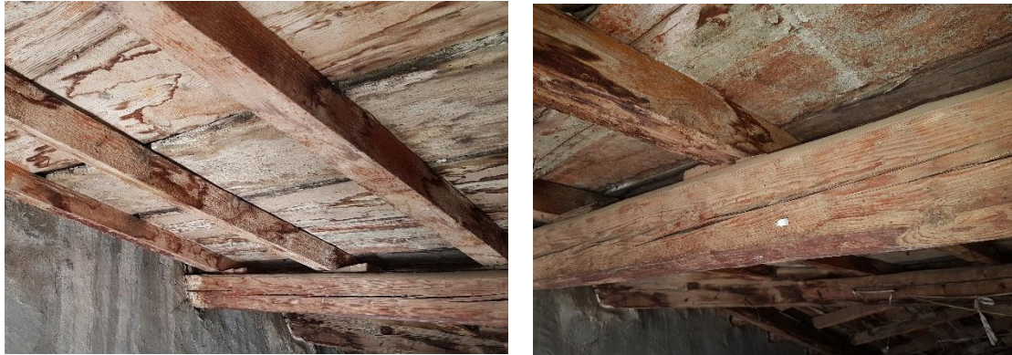
Εικόνα 5.7 – Διάβρωση της ξυλείας της στέγης από την υγρασία
