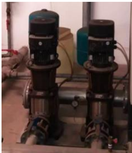
Εικόνα 10: Αντλία ανύψωσης πίεσης- Booster σε εγκατάσταση.
