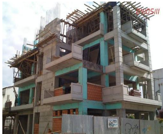
Εικόνα 1.2: Αυθαιρέτη ανέγερση πολυκατοικίας σε περίπτωση που δεν έχει εκδοθεί οικοδομική άδεια (βλ. εικ. 1.1)
