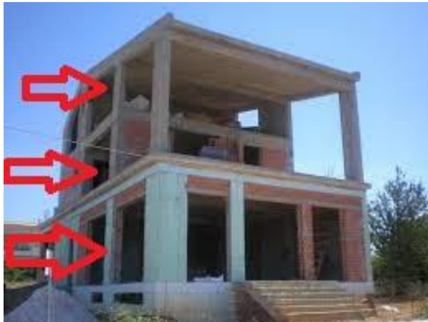
Εικόνα 1.3: Ανέγερση κατοικίας με υπέρβαση ορόφων σύμφωνα με την υπάρχουσα οικοδομική άδεια (βλ. εικ. 1.4).
