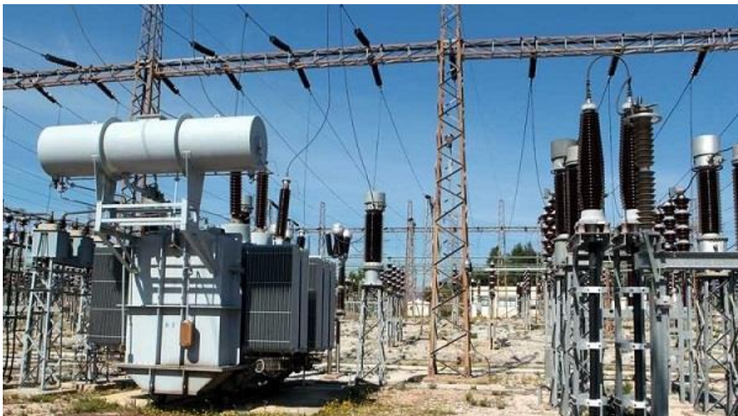
Σχήμα 4.17: Υποσταθμός υψηλής τάσης στη Λάρισα [30]
