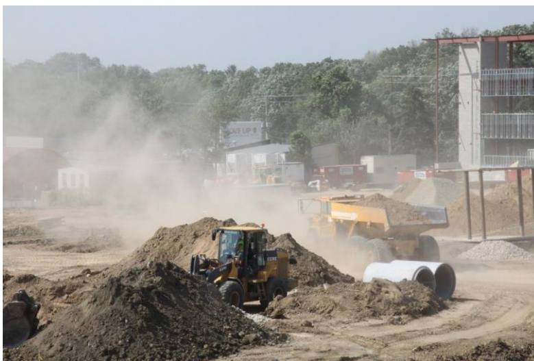
Εικόνα 2: Σκόνη και θόρυβος από εργασίες κατασκευής [2]
