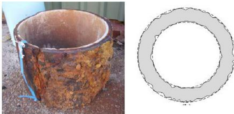
Εικόνα 6.2: Γενικευμένη διάβρωση στην εξωτερική επιφάνεια μεταλλικού αγωγού, και σχηματική αναπαράσταση (Rajeev et al., 2013).
