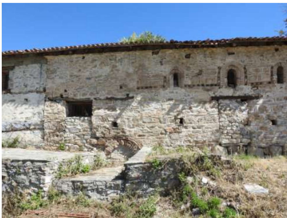
Εικ. 8 Ερείπια κτιστής στοάς – νότια πλευρά του ναού
