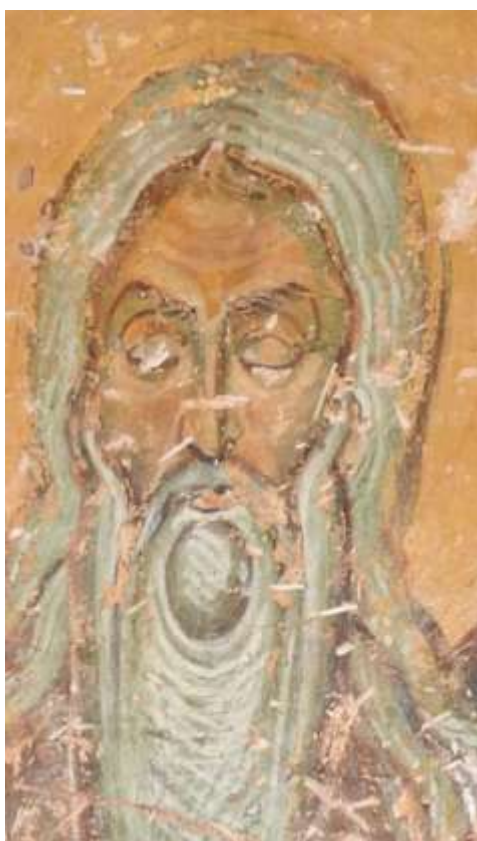
Εικ.143 Ανατολικός τοίχος ιερού Τεχνική secco. Απολεπίσεις ζωγραφικής επιφάνειας, Α' φάσης.
