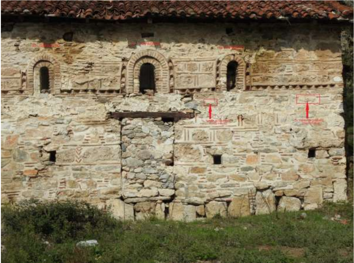
Εικ.135 1 ο & 2 ο εναπομείναντα τοιχογραφημένα βυζαντινά τμήματα. Θέση 1 ου , 2 ου , 3 ου μονόλοβου τοξωτού παράθυρου, στην νότια εξωτερική πλευρά του μνημείου
