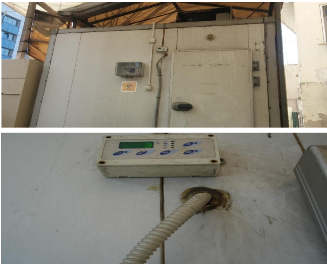
Εικόνα 4.10 Ψυκτικός θάλαμος προσωρινή; Αποθήκευσης ΕΑΑΜ και ΜΕΑ
