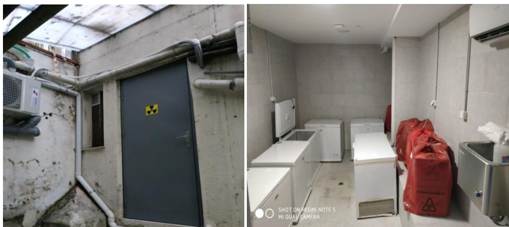
Εικόνα 4.12 Θάλαμος φύλαξης και προσωρινής αποθήκευσης ραδιενεργών αποβλήτων Γ.Ν.Α. «ΑΛΕΞΑΝΔΡΑ» (Πηγή: ΕΚΔΑΥΜ ΓΝΑ «ΑΛΕΞΑΝΔΡΑ»)
