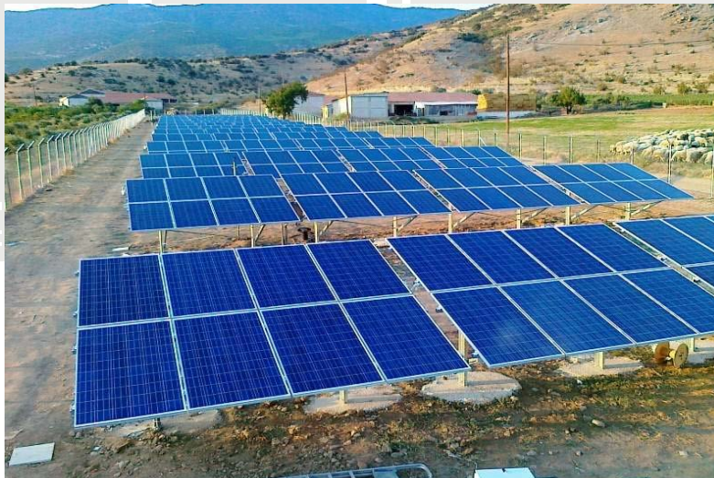
Εικόνα 3.5 Φωτοβολταϊκό Πάρκο ( πηγή: https://www.sunen.gr/ )
