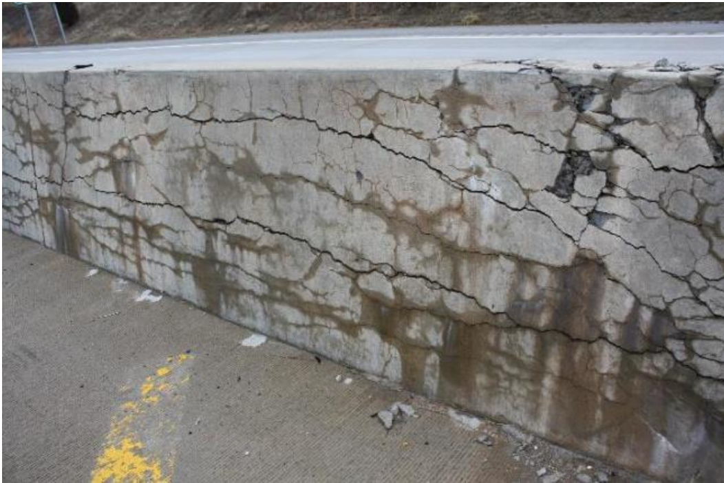
Εικόνα 7.5 Επίδραση της Αλκαλοπυριτικής Αντίδρασης ASR στο σκυρόδεμα Πηγή: Deschênes, R. Albert (2017)
