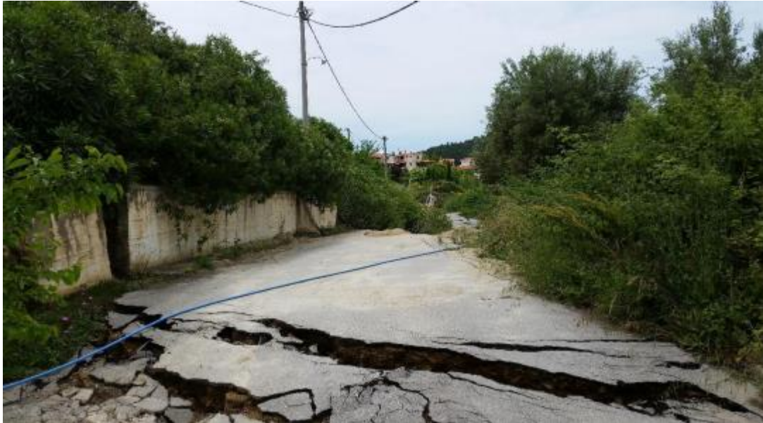
Εικόνα 1.4 Καθίζηση οδοστρώματος Πηγή: Καμελίδης, Α. Φ. (2020)
