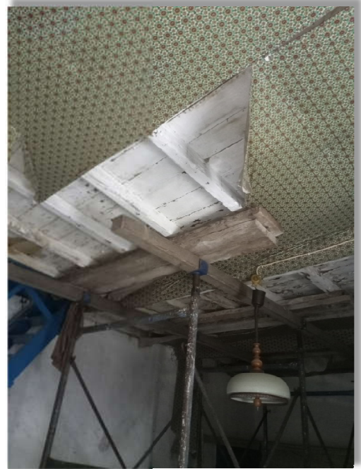
Εικόνα 3.23: Αποσάθρωση και κάμψη ξύλινων δοκών μεσοπατώματος
