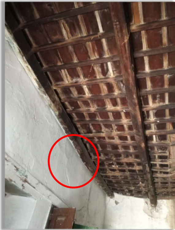
Εικόνα 3.18: Ρωγμές και αποδιοργάνωση της τοιχοποιίας στη στέψη
