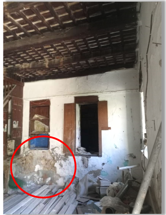
Εικόνα 3.19: Αποδιοργάνωση της τοιχοποιίας στην βάση της
