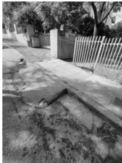
Εικόνα 8.55: Κακότεχνη ράμπα εισόδου – εξόδου ιδιωτικής θέσης στάθμευσης. Πηγή: (Αρχείο Δ/νσης Τεχνικών Υπηρεσιών Δήμου Αγίας Παρασκευής, 2022)
