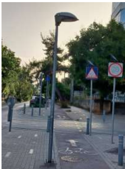
Εικόνα 5.4: Φωτοβολταϊκές πινακίδες ΚΟΚ διάβασης πεζών και ορίου ταχύτητας, στο δίκτυο πεζής μετακίνησης οδού Δερβενακίων στο Δήμο Αγίας Παρασκευής
