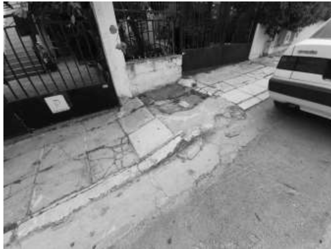
Εικόνα 8.51: Επικίνδυνη ανισοσταθμία πεζοδρόμιου και κατεστραμμένη πλακόστρωση. Πηγή: (Αρχείο Δ/σης Τεχνικών Υπηρεσιών Δήμου Αγίας Παρασκευής, 2022)
