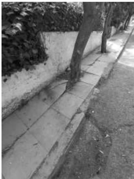
Εικόνα 8.53: Ανασηκωμένες πλάκες πεζοδρομίου από τις ρίζες δέντρων, μικρού πλάτους πεζοδρόμιο.
