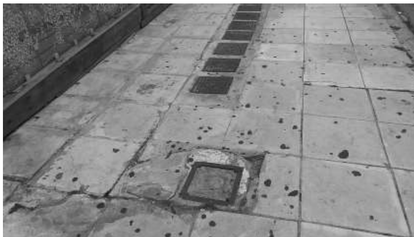
Εικόνα 8.32: Κατεστραμμένα πεζοδρόμια στην οδό Ηρώων Πολυτεχνείου, χωρίς τη ύπαρξη όδευσης τυφλού και χαμηλού φωτισμού.
