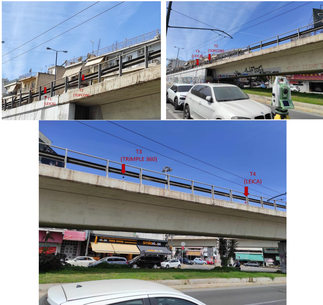
Εικόνα 24 Θέσεις τοποθέτησης πρισμάτων στο τμήμα της γέφυρας με αρμό.
