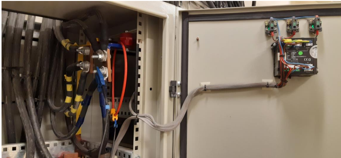
Εικόνα 6.11.2 Σύνδεση ενεργειακού αναλυτή
