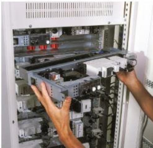
Εικόνα 3.19: Αποσύνδεση μια μονάδας από τον πίνακα [37]
