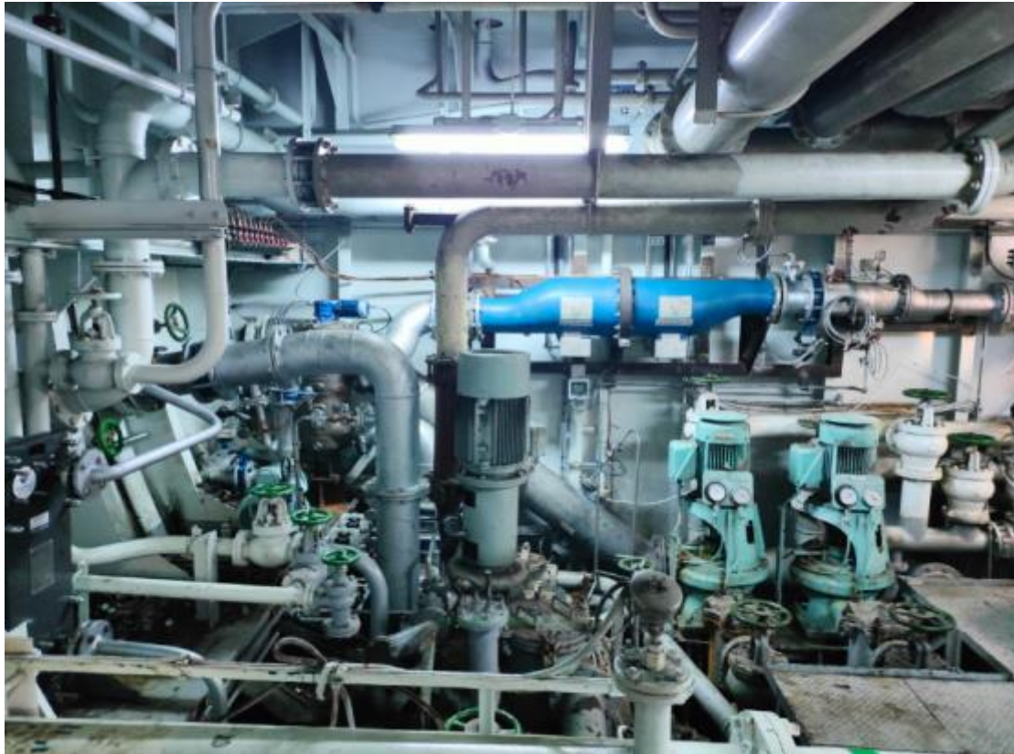
Εικόνα 5.3: Σύστημα BWTS σε μηχανοστάσιο
