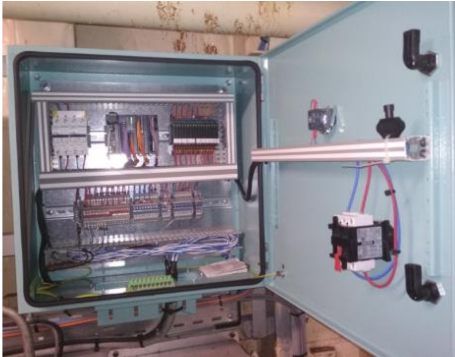
Εικόνα 4.52: Εικόνα πίνακα με PLC
