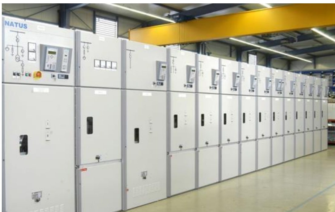
Εικόνα 3.12: Πίνακες Μέσης Τάσης [36]
