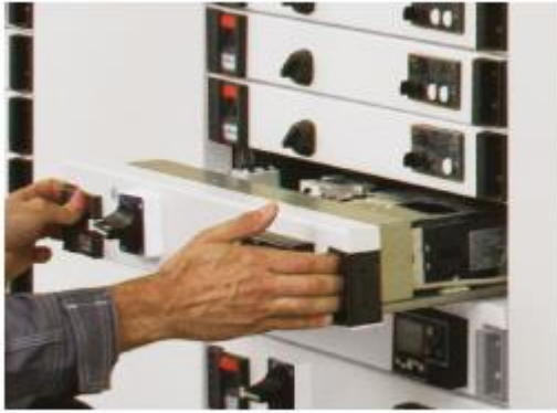
Εικόνα 3.20: Πίνακας διανομής, που περιέχει συρταρωτές μονάδες [37]
