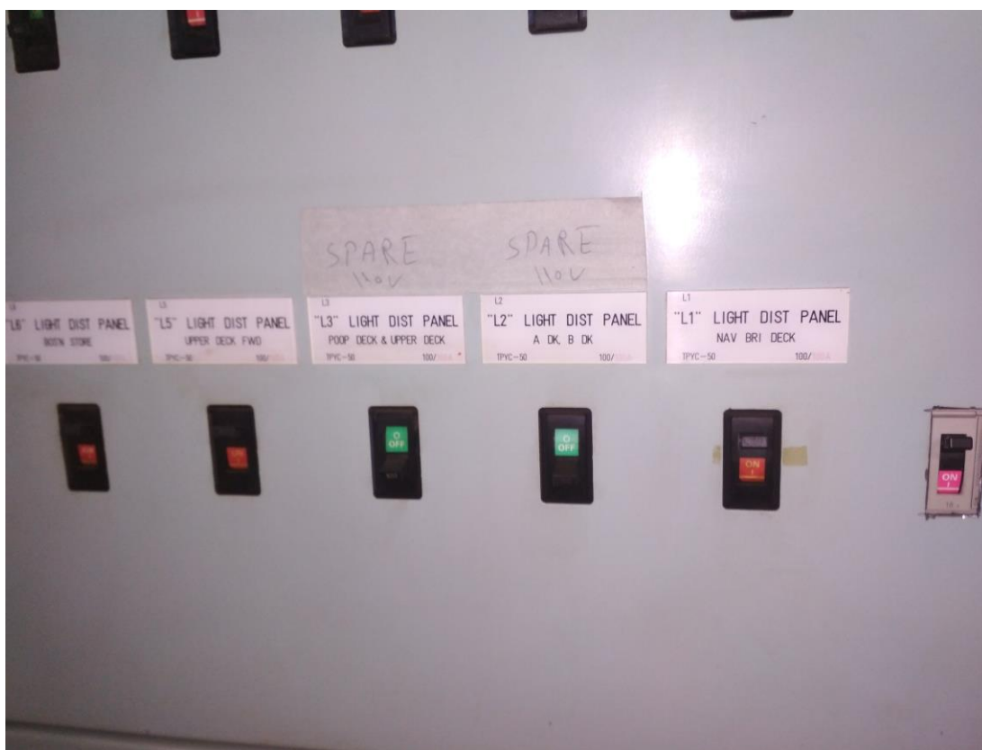
Εικόνα 3.13: Ένδειξη σε πίνακες και εγκοπές στον πίνακα για να φαίνονται οι διακόπτες
