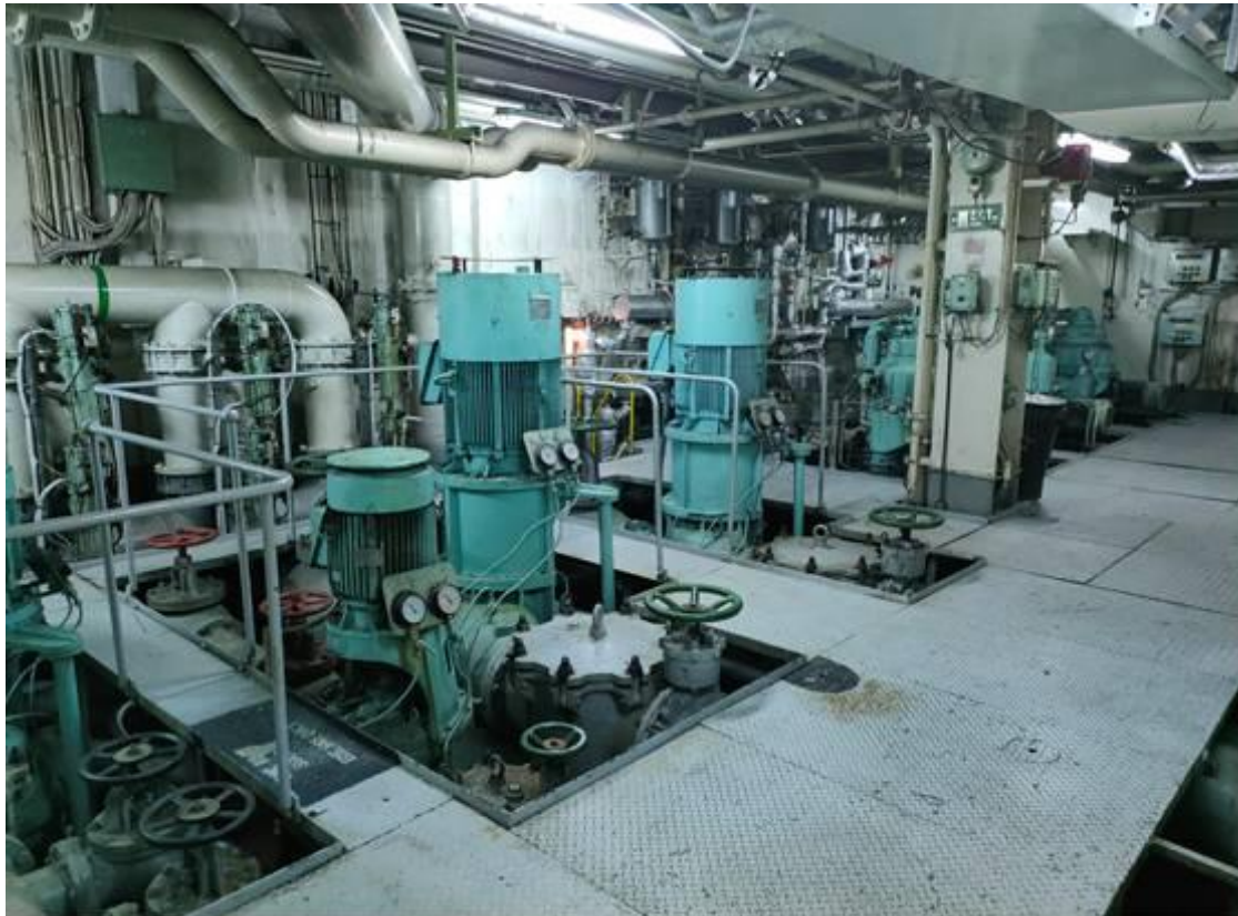
Εικόνα 2.5: Εσωτερική εγκατάσταση πλοίου (μηχανοστάσιο)
