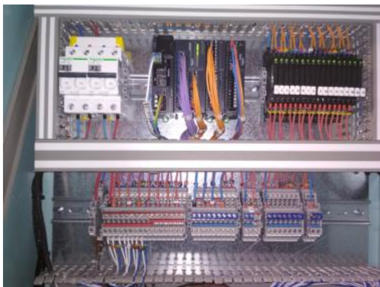
Εικόνα 4.51: Εικόνα πίνακα με PLC
