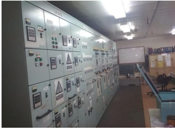
Εικόνα 3.4: Πίνακας επί δαπέδου σε πλοία
