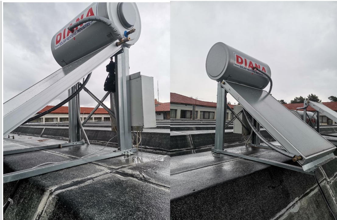
Εικόνα 1. Εγκατάσταση θερμοσιφωνικού συστήματος (ανοιχτού τύπου).
