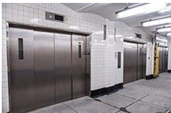
Εικ. 16 - Ανελκυστήρας με αυτόματες και συρόμενες πόρτες(Πηγή: Ασασέρ-Wikiλεξικό, 2020)
