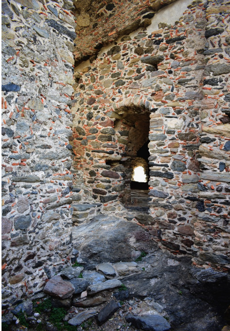
Εικ. 12. 13..Εσωτερικό Κάστρου Βατίκων. Τοιχοποιία κατασκευασμένη με ακατέργαστες πέτρες συνδεδεμένες με κονίαμα (μείγμα φυσικών αδρανών υλικών).
