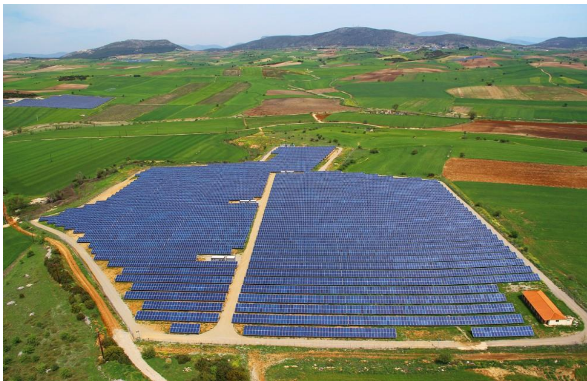
Σχήμα 5. 1: Φ/Β εγκατάσταση Α
