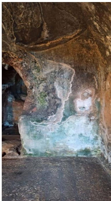
Εικ.5.11: Εκτεταμένη απώλεια κονιάματος στα επιχρίσματα/τοιχογραφίες, συσσώρευση γαιωδών και παρουσία βιολογικών επικαθίσεων στον θάλαμο Υ, Νικοδήμου Π., 2021.
