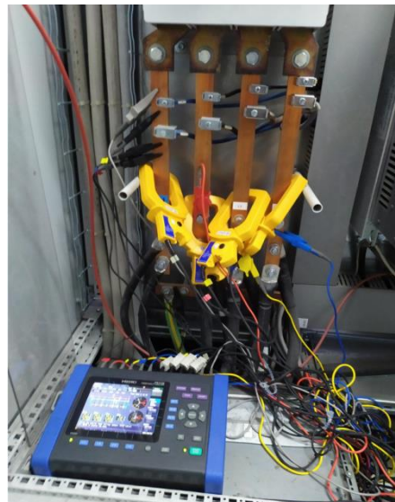
Εικόνα 0.24 Τοποθέτηση του οργάνου με σωστό τρόπο ώστε να αποφευχθεί να δημιουργηθεί κάποιο ατύχημα κατά την παραμονή του μέσα στον βιομηχανικό πίνακα.
