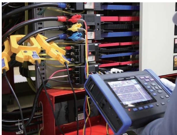
Εικόνα.1Όργανο ανάλυσης ποιότητας ηλεκτρικής ισχύος HIOKI PW 3198 κατά τη διάρκεια λήψης μέτρησης ηλεκτρολογικών μεγεθών από βιομηχανικό πίνακα, μέσω τοποθετημένων αμπερομετρικών στις γραμμές και ειδικών ακροδεκτών για λήψη τιμών τάσεις ανά φάση
