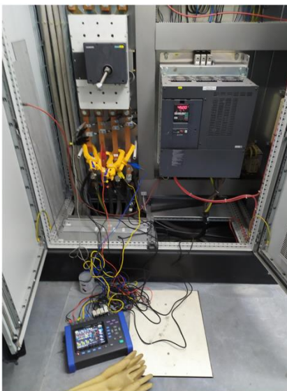
Εικόνα 0.26 Κατά την τοποθέτηση του οργάνου στον βιομηχανικό πίνακα, φαίνονται τα γάντια προστασίας από τα ηλεκτρικά τόξα προστασίας 1000Volt.
