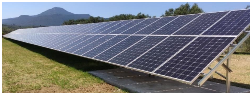
Εικόνα 76: Φωτοβολταϊκά πάνελ. Πηγή: www.ecosun.gr
