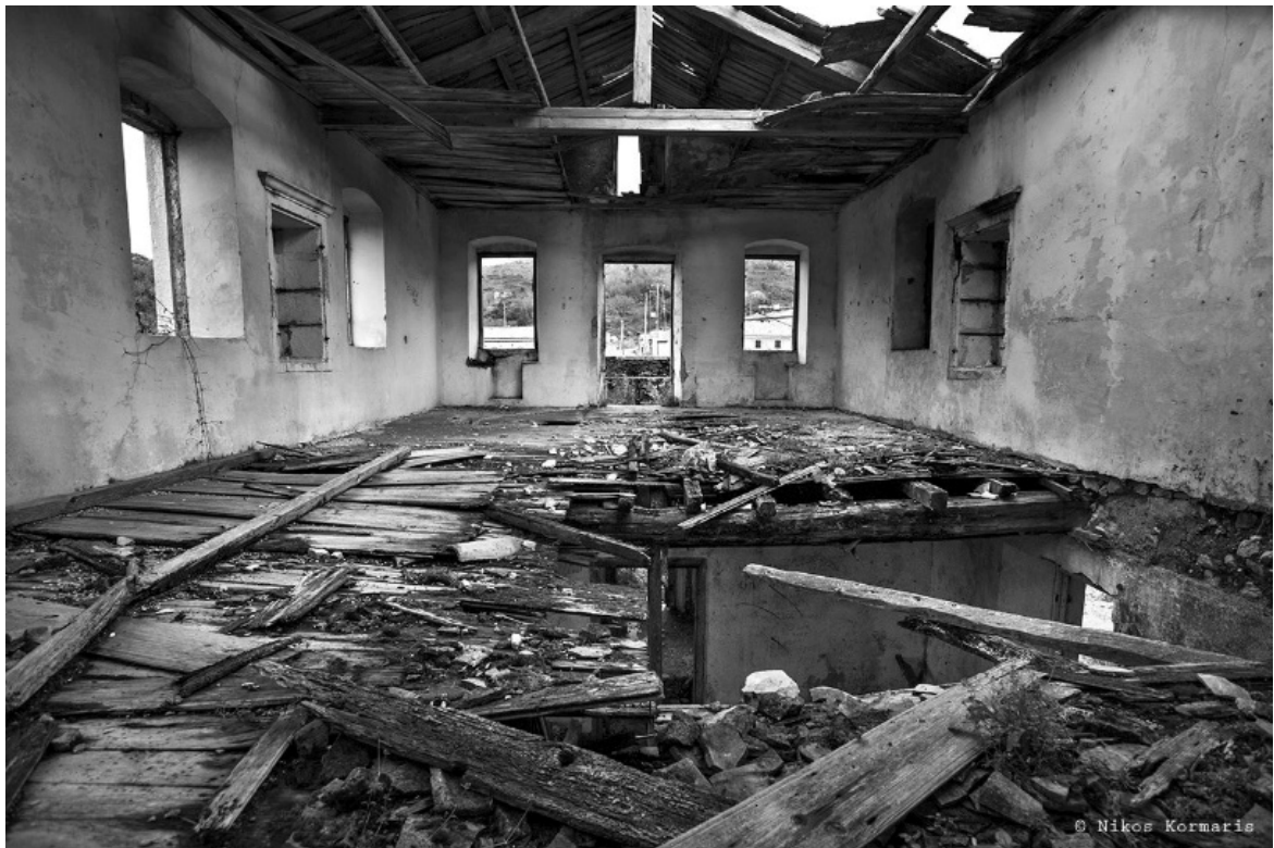
Εικόνα 19 Φθορές πατώματος στον α' όροφο Πηγή: Φωτογραφικό αρχείο Νίκου Κορμαρή
