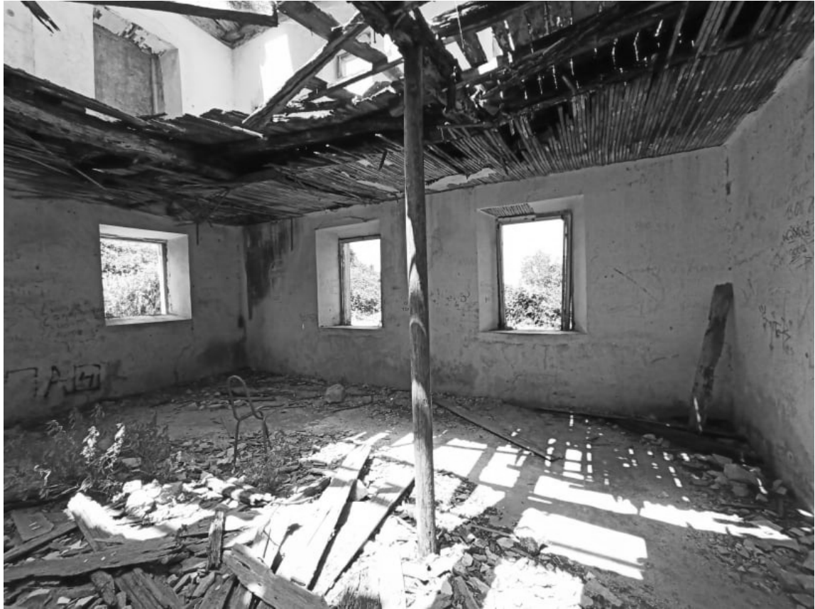
Εικόνα 14 Μεταγενέστερη προσθήκη ξύλινου κορμού για στήριξη πατώματος Πηγή: Προσωπικό φωτογραφικό αρχείο
