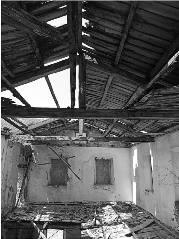
Εικόνα 20 Φθορές στέγης Πηγή: Προσωπικό φωτογραφικό αρχείο
