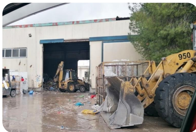
Εικόνα 17 - Κέντρο Διαλογής Ανακυκλώσιμων Υλικών (ΚΔΑΥ)
