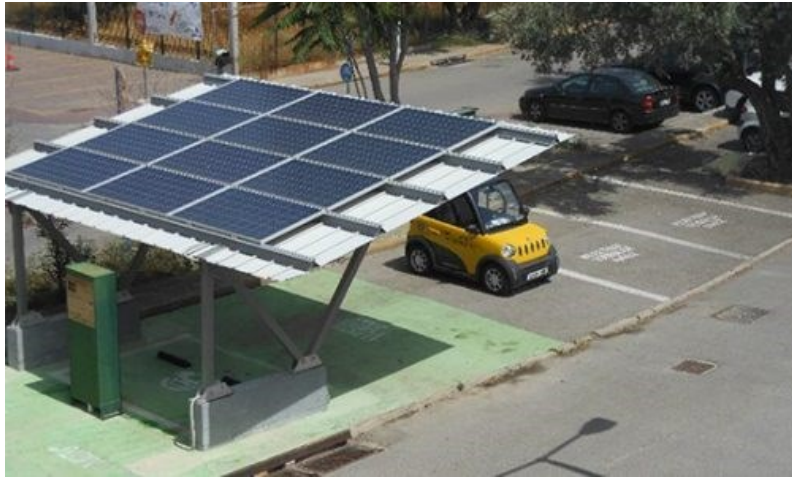
Εικόνα 19: Φωτοβολταϊκά πάνελ και σταθμός φόρτισης ηλεκτρικού αυτοκινήτου
