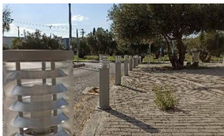
Εικόνα 13: Φωτιστικά διάβασης στο ΠΑΔΑ (Πηγή Φωτογραφιών από τον ιστότοπο του ΠΑΔΑ)
