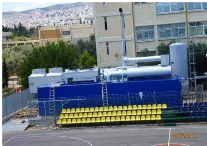
Εικόνα 18: Σταθμός συμπαραγωγής ενέργειας στο ΠΑΔΑ (Πηγή Φωτογραφιών από τον ιστότοπο του ΠΑΔΑ)
