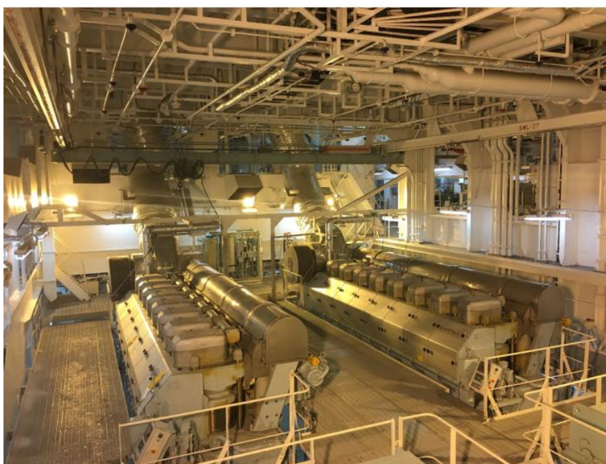
Εικόνα 96: Μηχανοστάσιο FSRU με μηχανές διπλού καυσίμου (LEIF HÖEGH & CO, 2020, p. 10)
