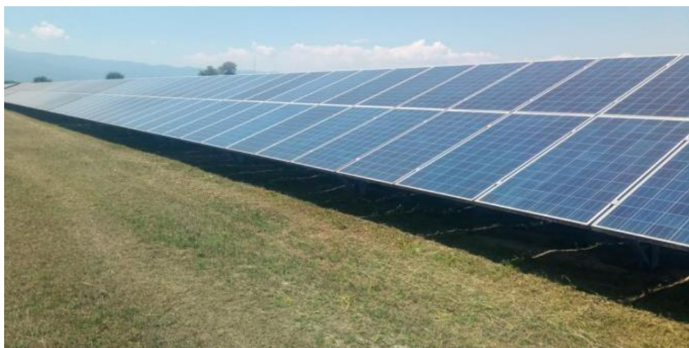
Εικόνα 16. Φωτοβολταϊκά Πάνελ. Πηγή: «Η Επίδραση της Μετεωρολογίας στα Φωτοβολταϊκά Συστήματα στην Ελλάδα», Αθηνά Μαύρου.
