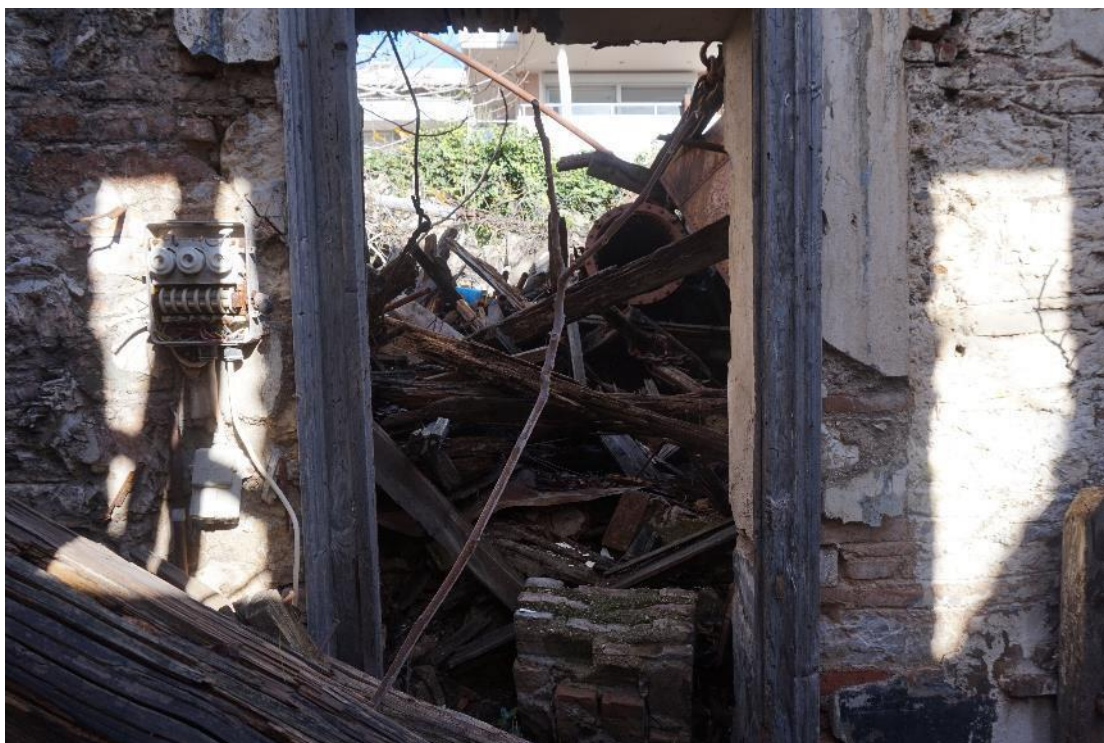
ΕΙΚΟΝΑ 185 Άνοιγμα πορτας, διακρινεται στο εσωτερικο η καταρρευση του κτισματος.
