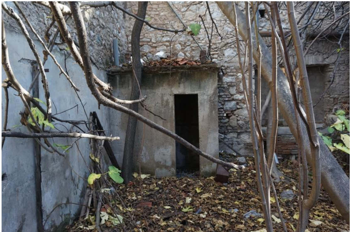
ΕΙΚΟΝΑ 164 ΕΣΩΤΕΡΙΚΗ ΑΠΟΨΗ ΤΩΝ ΕΡΕΙΠΙΩΝ, ΔΙΑΚΡΙΝΕΤΑΙ ΕΝΑ ΜΙΚΡΟ ΤΣΙΜΕΝΤΕΝΙΟ ΚΤΙΣΜΑ, ΠΙΘΑΝΟΝ ΜΕΤΑΓΕΝΕΣΤΕΡΗΣ ΠΡΟΣΘΗΚΗΣ.
