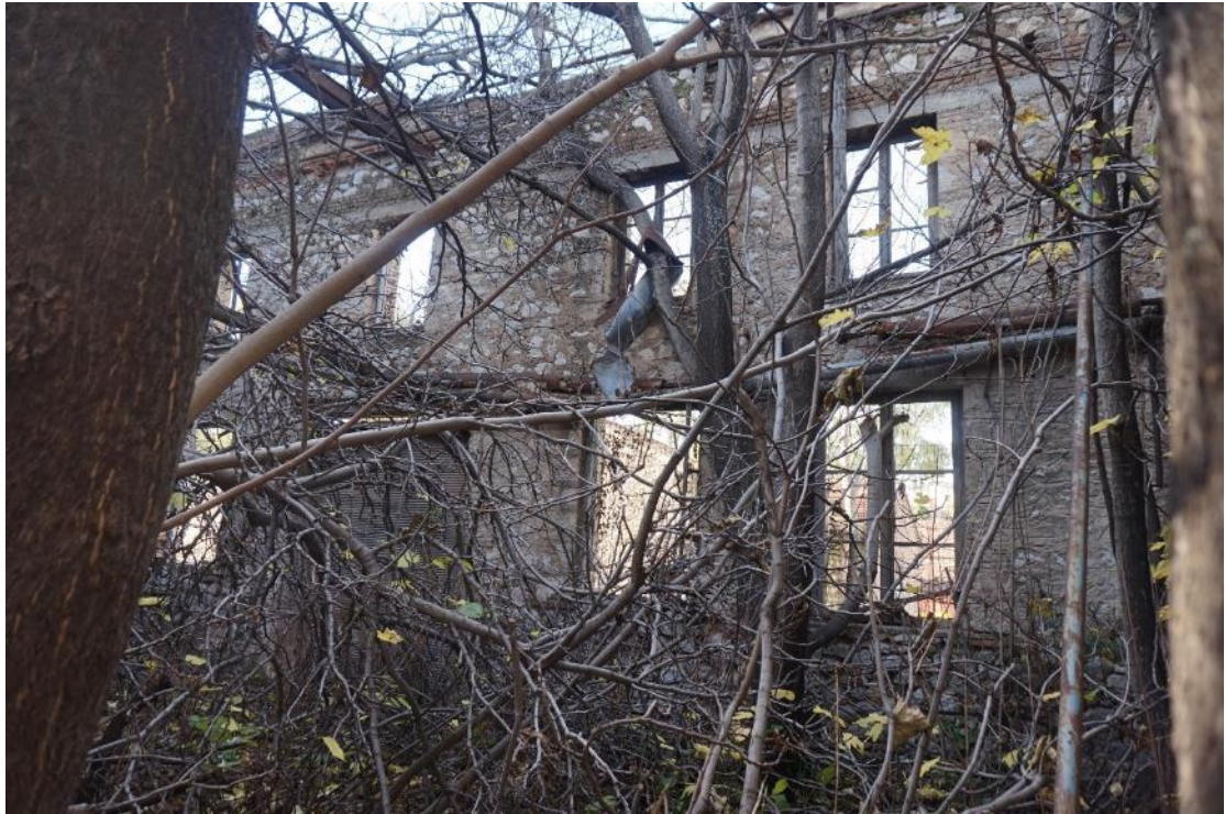
ΕΙΚΟΝΑ 163 ΕΣΩΤΕΡΙΚΗ ΑΠΟΨΗ ΤΩΝ ΕΡΕΙΠΙΩΝ, ΓΙΝΕΤΑΙ ΑΝΤΙΛΗΠΤΟΣ Ο ΒΑΘΜΟΣ ΕΓΚΑΤΑΛΕΙΨΗΣ ΤΟΥΣ.
