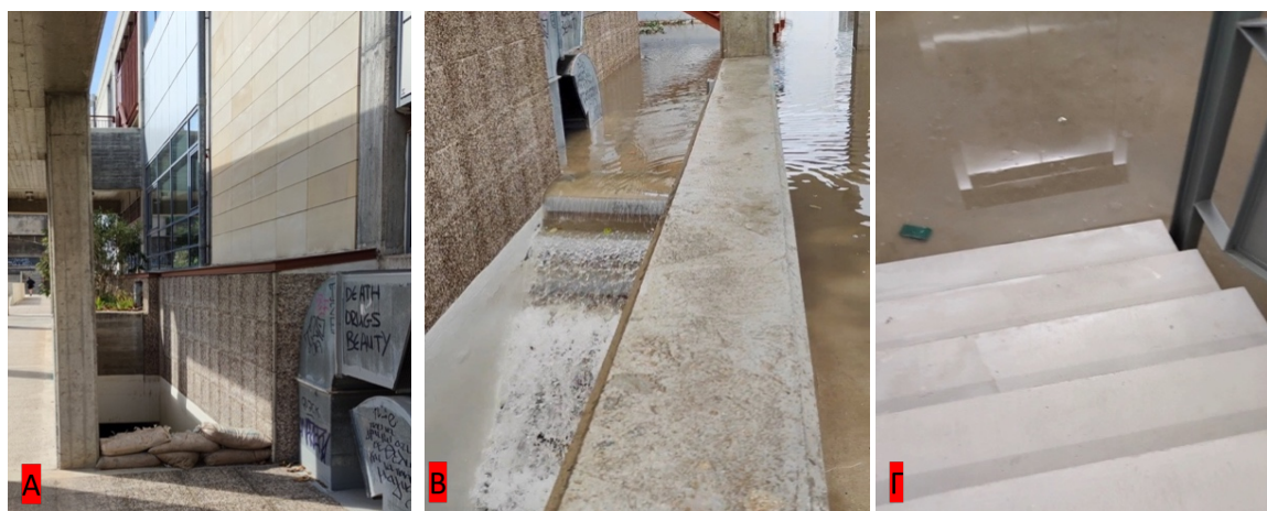
Εικόνα 6.27. Εξωτερική και εσωτερική σκάλα εισροής υδάτων
