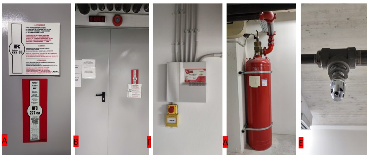
(Α) Προειδοποιητική ένδειξη έξω από το πυροδιαμέρισμα, (Β) Θύρα πυροδιαμερίσματος από την έξω πλευρά, που έχει φωτεινή ένδειξη «gas-αέριο» και κουδούνι, που ενημερώνουν για να αποτρέψουν την είσοδο στο χώρο όταν είναι ενεργοποιημένα, (Γ) Διακόπτης ενεργοποίησης πυρόσβεσης και συναγερμού για το συγκεκριμένο πυροδιαμέρισμα, (Δ) Ατσάλινος κύλινδρος αποθήκευσης HFC 227ea (M-200) με πίεση αζώτου. (Ε) Ο ψεκαστήρας αερίου HFC 227ea (M-200) εντός της αποθήκης του 1ου υπογείου. Πηγή: προσωπικό αρχείο
