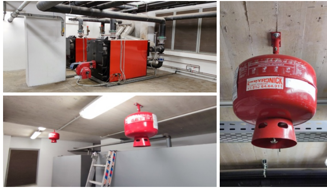
Εικόνα 6.51. Χώρος λεβητοστασίου και δεξαμενών πετρελαίου στο 1ο υπόγειο. Κρεμάμενος πυροσβεστήρας ξηράς κόνεως. Πηγή: προσωπικό αρχείο.
