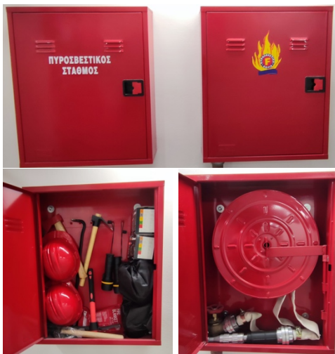
Εικόνα 6.46. Πυροσβεστική φωλιά και πυροσβεστικός σταθμός
