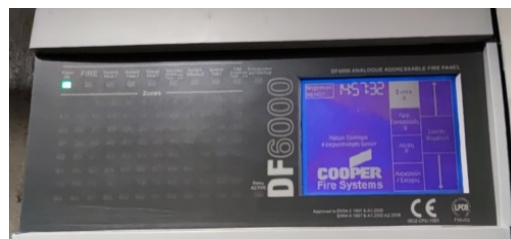
Εικόνα 6.44. Κεντρικός πίνακας συστήματος πυρασφάλειας Πηγή: προσωπικό αρχείο
