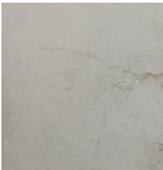
Εικόνα 23 : Ρωγμή στον σοβά
