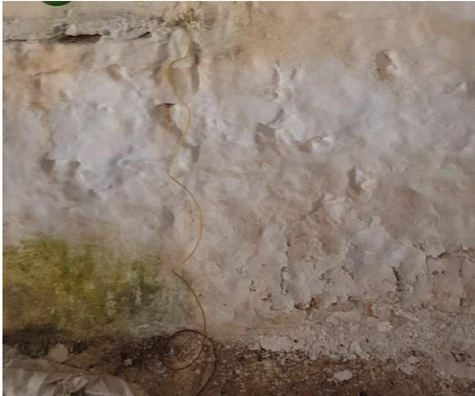
Εικόνα 26 : Υγρασία στην τοιχοποιία
