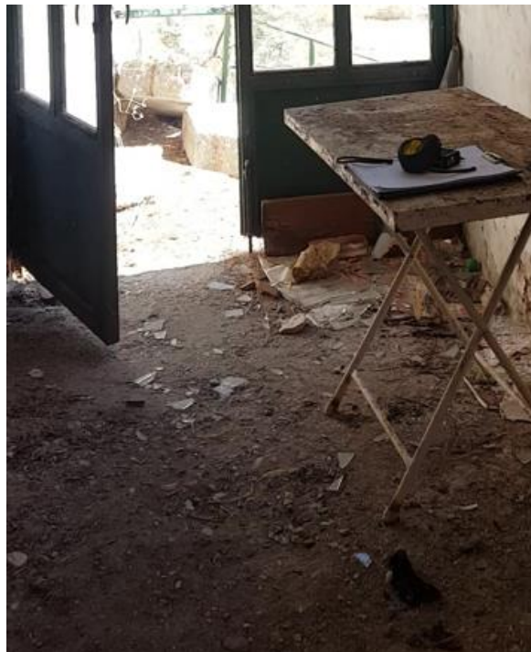
Εικόνα 31: Δάπεδο χωρίς επίστρωση
