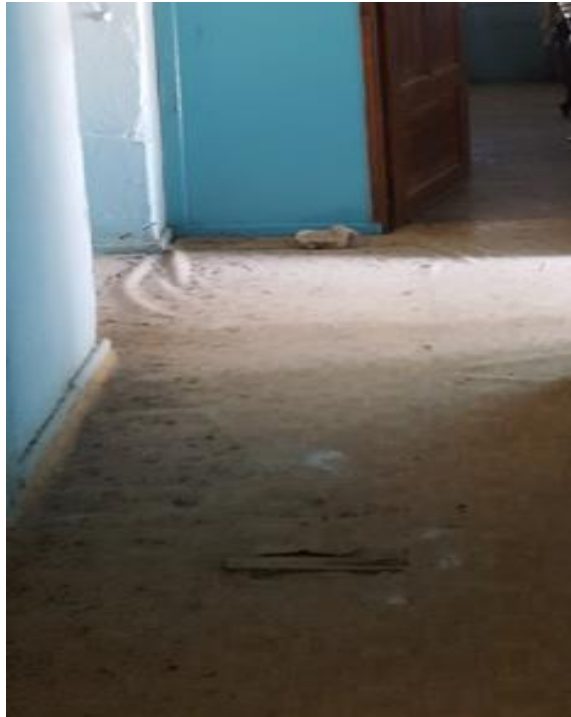
Εικόνα 30: Φθορές στο πλαστικό δάπεδο
