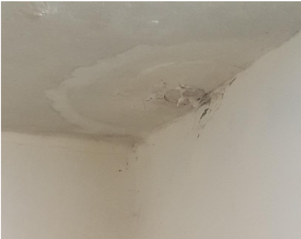
Εικόνα 27 : Υγρασία στην τοιχοποιία
