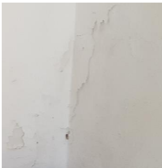
Εικόνα 24 : Ρωγμή στον σοβά
