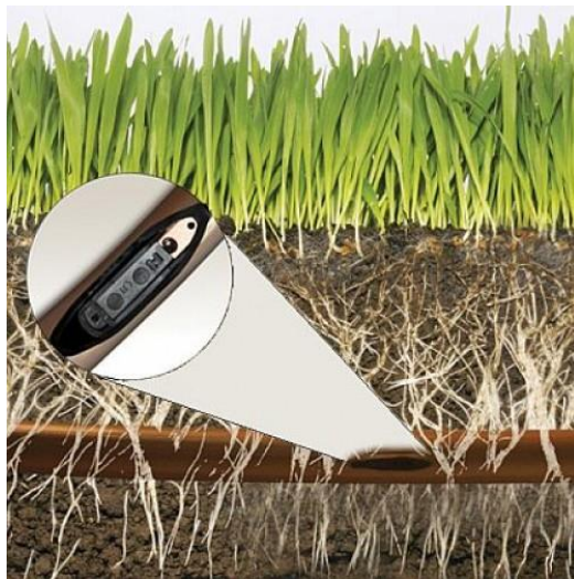
Εικόνα 76. Υπόγειο σταλακτοφόρο σύστημα άρδευσης (Irrigation - gr, 2022).
