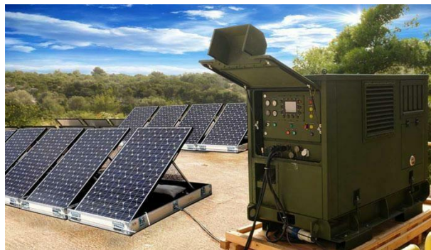
Εικόνα 1-3 Το Υβριδικό σύστημα ηλεκτρικής ενέργειας HEPS INTRACOM DEFENSE
