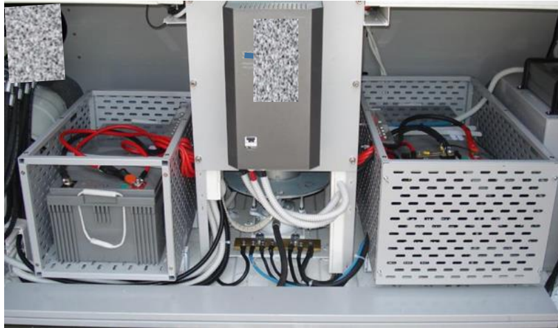
Εικόνα 5-1 Ο χώρος του συστήματος αποθήκευσης. Διακρίνεται σε πρώτο πλάνο ο αντιστροφέας καθαρού ημιτόνου, αριστερά του η μπαταρία τύπου Gel και πάνω δεξιά ο φορτιστής των 24V
