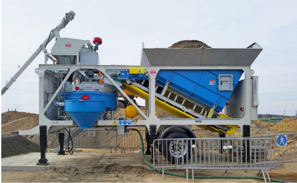
Εικόνα 6 Μηχάνημα παραγωγής σκυροδέματος στο χώρο του εργοταξίου
