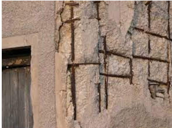
Εικόνα 23 Διάβρωση οπλισμού του σκυροδέματος
